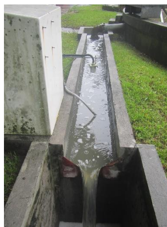
Figure 2.5 - Canal venturi en sortie
